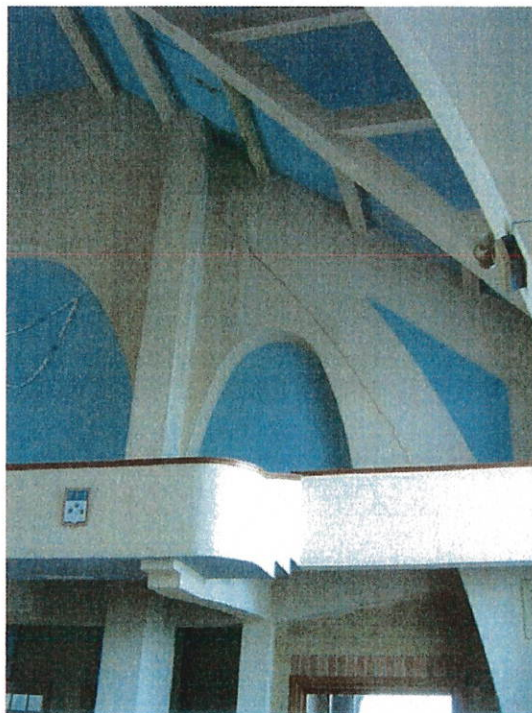
Photo 24 : Arche de l'entrée – Fissure de l'arche
