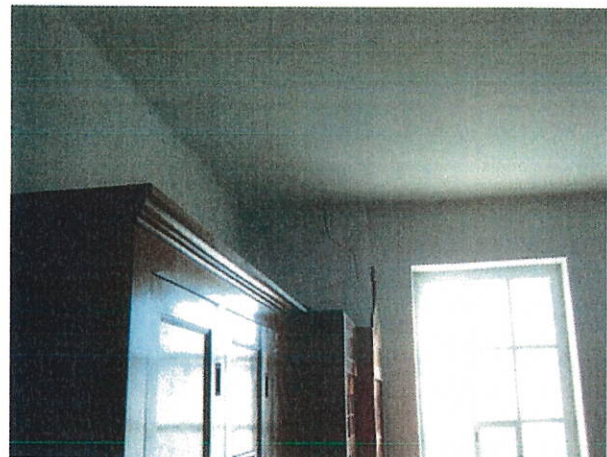
Photo 9b : Sacristie - Fissure dans la toiture et le mur – Janvier 2013
