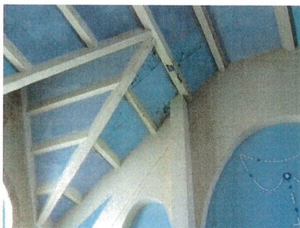
Photo 6b : Église - Dalle et poutres de la toiture endommagées ; Béton pourri et armature corrodée – Janvier 2013
