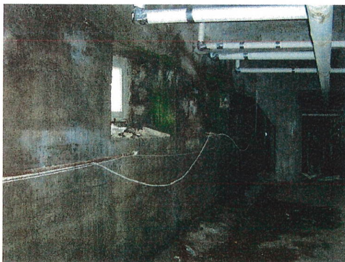
Photo 22 : Murs de fondation - Traces de pourriture et d'infiltration
