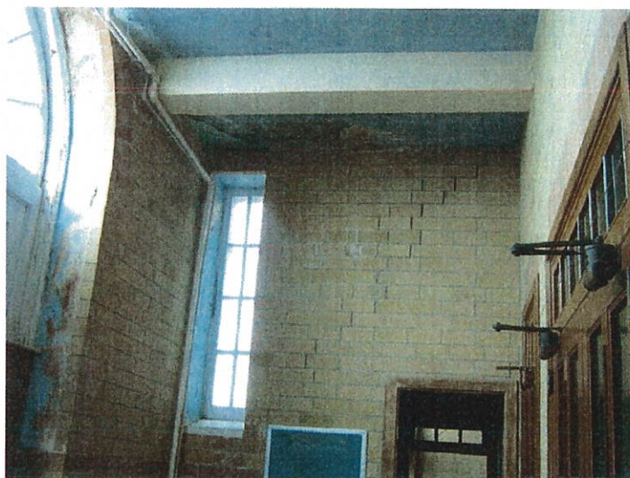
Photo 2 : Clocher - Structure endommagée du clocher à l'entrée principale Infiltration d'eau avec traces de calcaire
