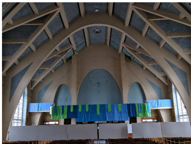
Photo 9b – Arche de l'entrée – Fissure sur la périphérie – Août 2019
