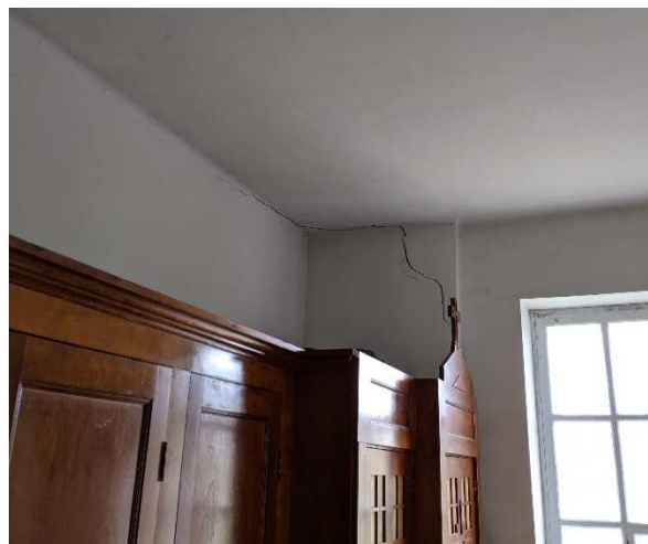
Photo 8b – Sacristie – Fissure dans la toiture et le mur – Août 2019
