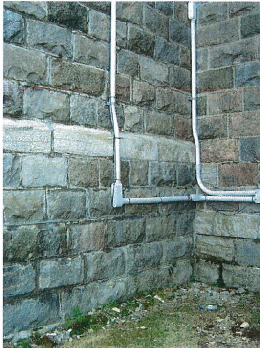
Photo 16 : Murs de fondation Humidité sur les pierres et présence de mousse (sol et pierres)
