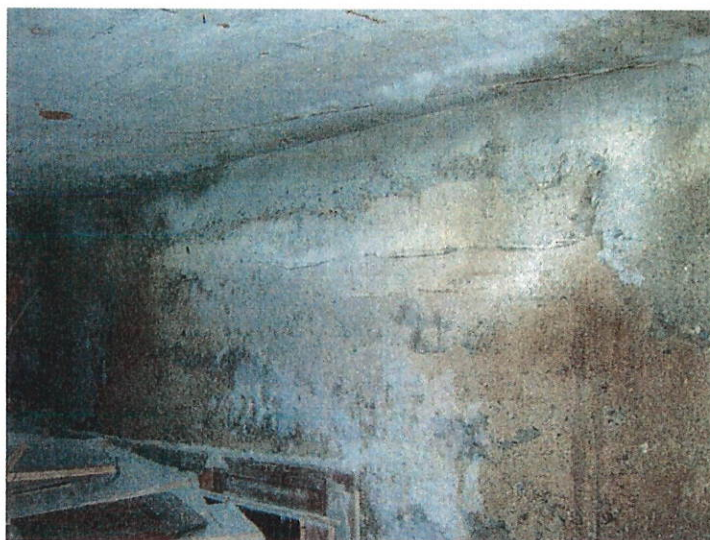
Photo 21 : Murs de fondation - Fissures, traces d'humidité et de pourriture
