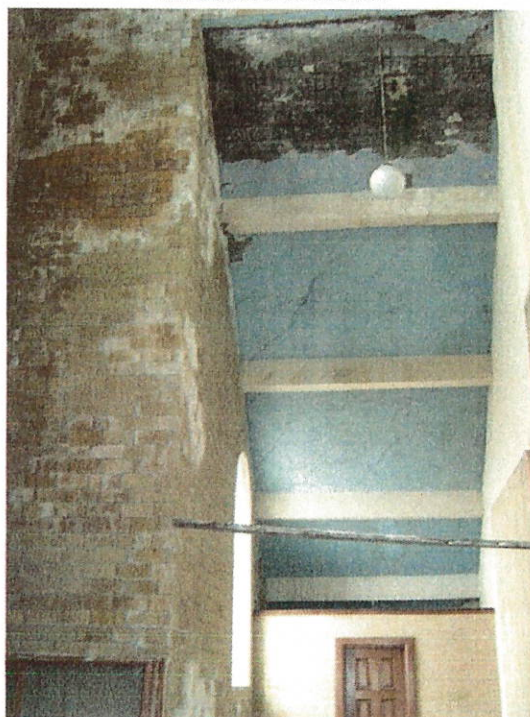
Photo 5 : Clocher - Béton endommagé et pourri, armature corrodée, infiltration d'eau avec traces de calcaire
