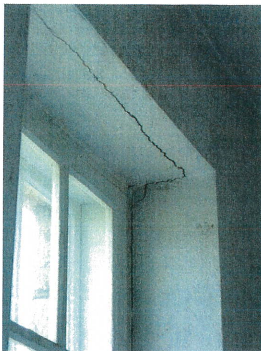
Photo 12 : Sacristie - Fissure au pourtour d'une fenêtre
