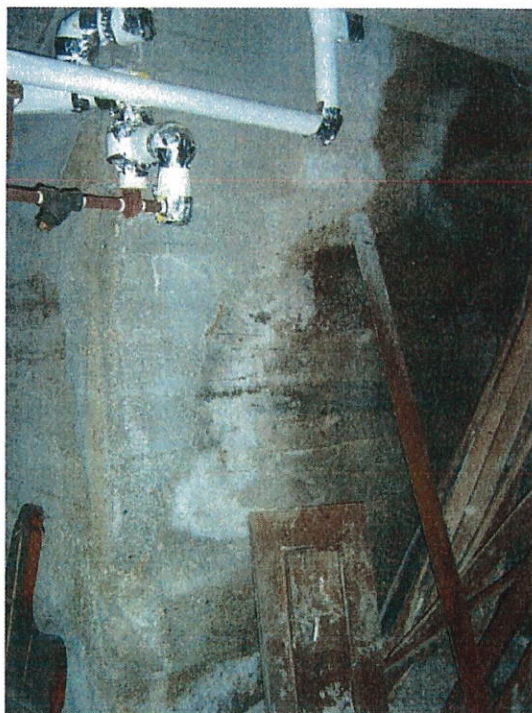
Photo 20 : Murs de fondation - Béton humide et traces de calcaire
