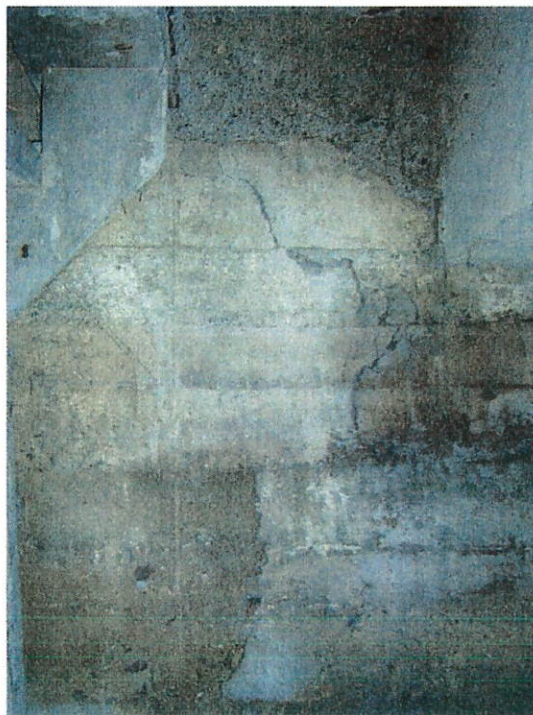
Photo 19 : Murs de fondation - Fissures dans les murs de fondation
