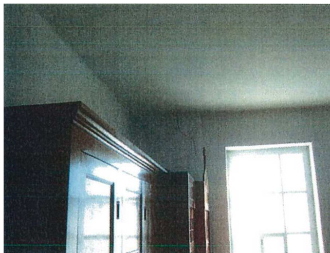
Photo 8a – Sacristie – Fissure dans la toiture et le mur – Janvier 2013
