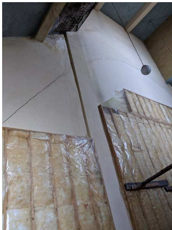
Photo 5 - Clocher - Fissure dans l'arche d'entrée - Août 2019
