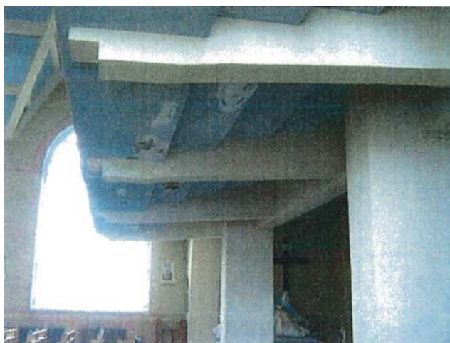
Photo 7a – Structure du jubé endommagée – Janvier 2013
