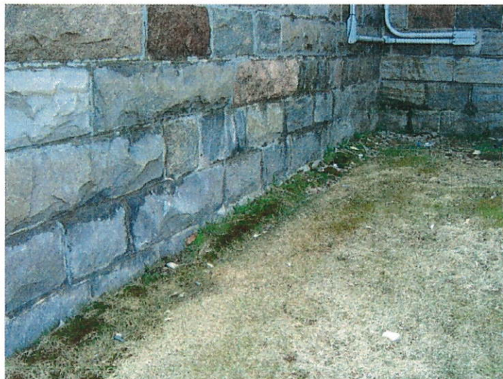
Photo 17 : Murs de fondation - Présence de mousse en périphérie de l'église
