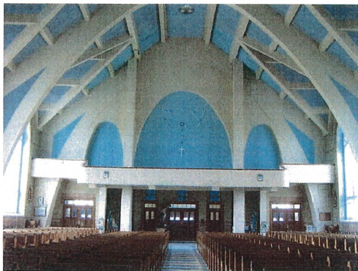
Photo 23 : Arche de l'entrée – Fissure sur la périphérie
