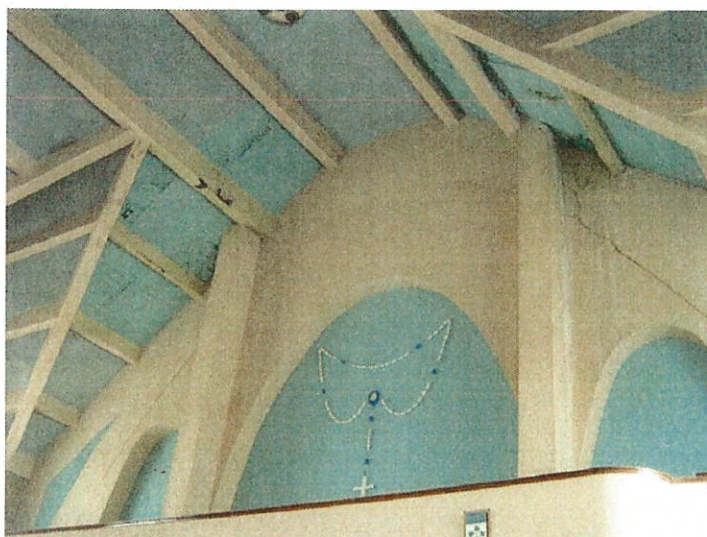
Photo 6 : Église - Dalle et poutres de la toiture endommagées Béton pourri et armature corrodée
