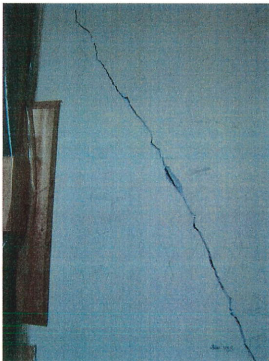
Photo 25 : Fissure de l'arche d'entrée – Suivi de la largeur d'ouverture
