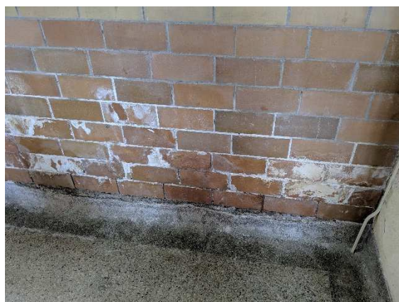
Photo 14 – Nef de l'église – Infiltration d'eau, moisissure et traces de calcaire sur les murs – Août 2019
