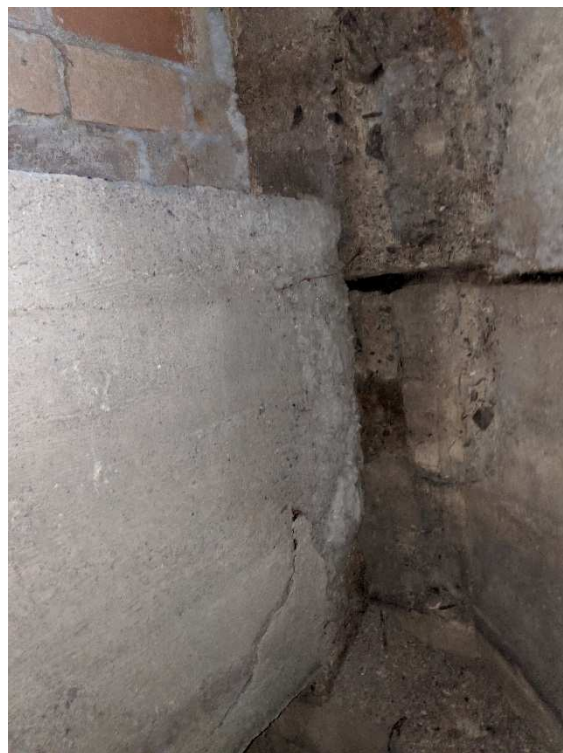
Photo 12 – Infiltration d'eau et moisissure sur les murs et la dalle de béton – Août 2019
