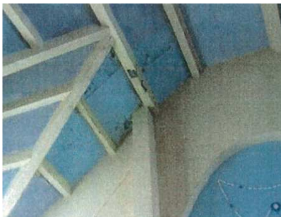
Photo 6a - Nef de l'église - Dalle et poutres de la toiture endommagées; Béton pourri et armature corrodée - Janvier 2013
