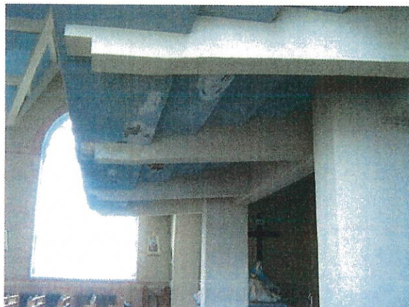
Photo 7a : Église - Structure du jubé endommagée – Juin 2009
