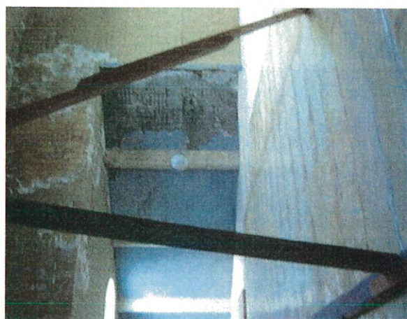
Photo 5b : Clocher - Béton endommagé et pourri, armature corrodé; infiltration d'eau avec traces de calcaire – Janvier 2013
