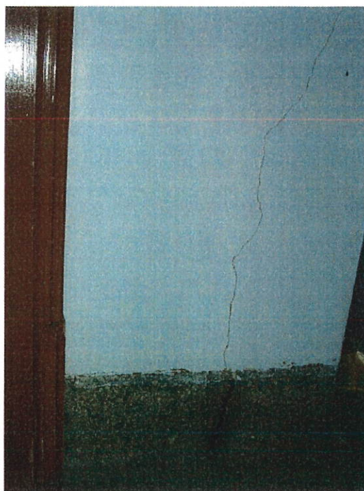
Photo 14 : Sacristie - Fissure dans un mur
