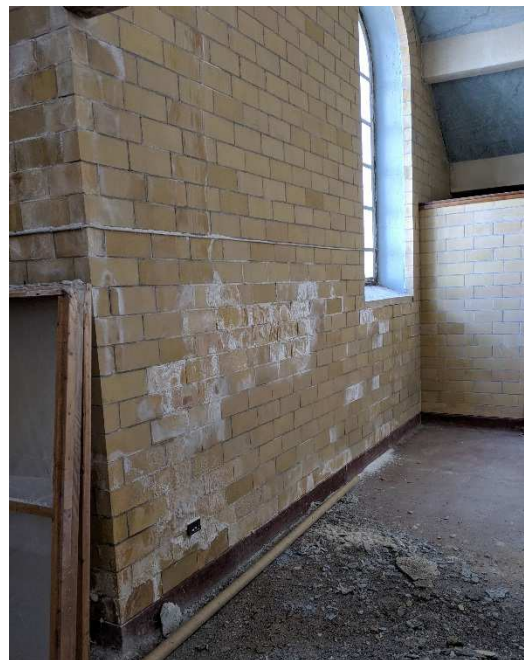
Photo 2b - Clocher - Infiltration d'eau dans les murs avec traces de calcaire – Août 2019
