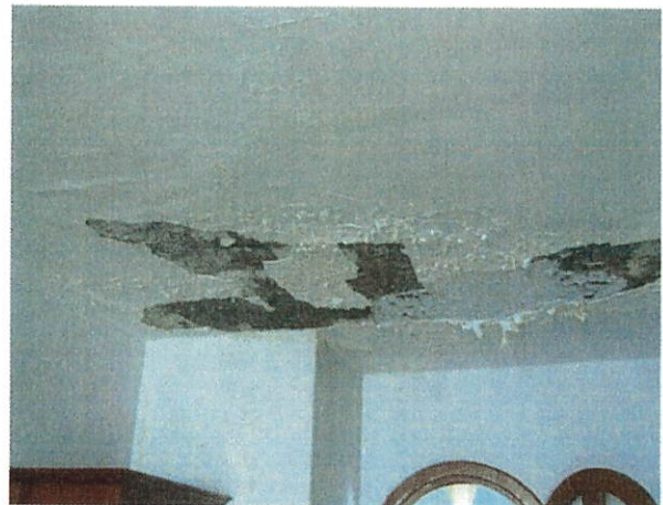
Photo 8b : Sacristie – Infiltration d'eau à la toiture, revêtement endommagé, béton humide – Janvier 2013
