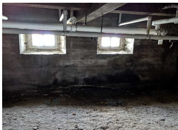
Photo 13 – Sous-sol de l'église - Infiltration d'eau, moisissure et traces de calcaire sur les murs de fondation – Août 2019
