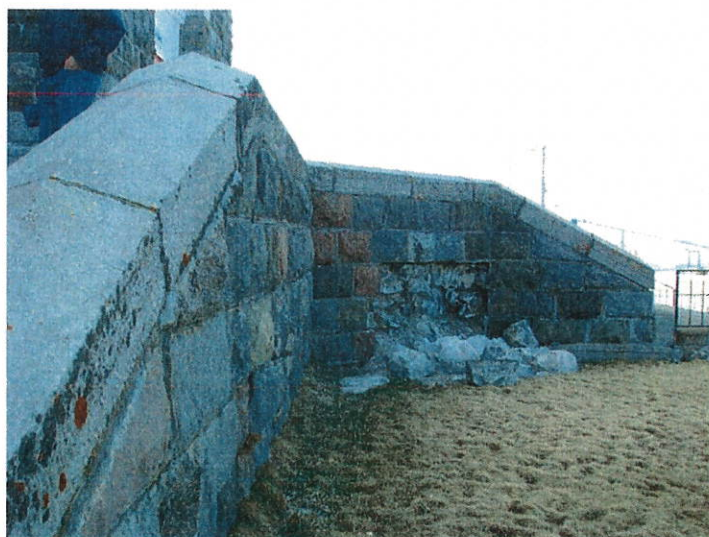
Photo 26 : Parvis de l'entrée - Parement de mur effondré
