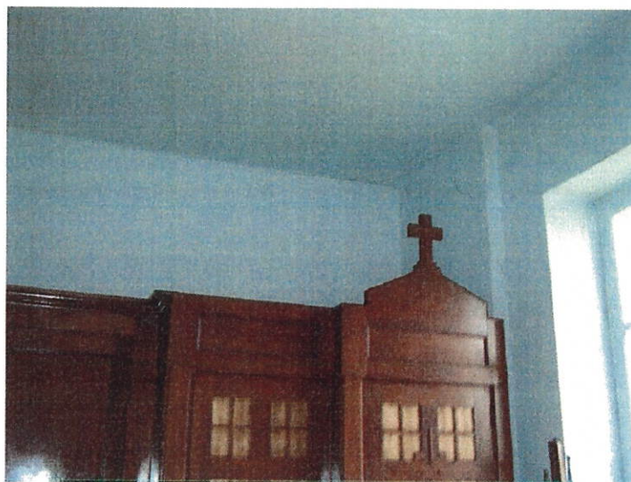
Photo 13 : Sacristie - Fissure dans la toiture et le mur
