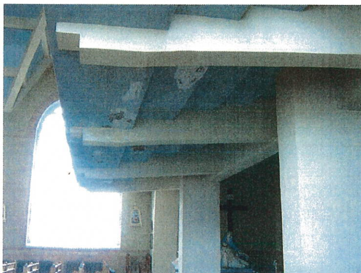
Photo 7 : Église - Structure du jubé endommagée
