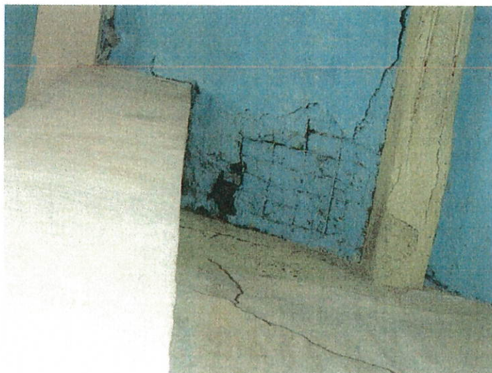
Photo 10 : Église - Infiltration d'eau dans la toiture, décollement du revêtement et du béton
