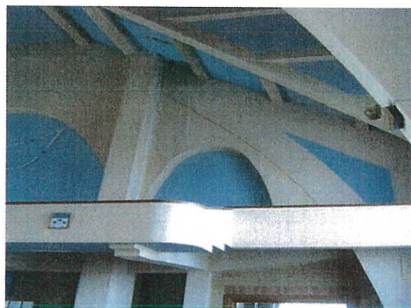
Photo 11a : Arche de l'entrée – Fissure de l'arche – Juin 2009
