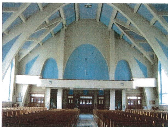
Photo 10a : Arche de l'entrée – Fissure sur la périphérie – Juin 2009
