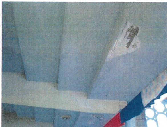
Photo 7b : Église - Structure du jubé endommagée – Janvier 2013
