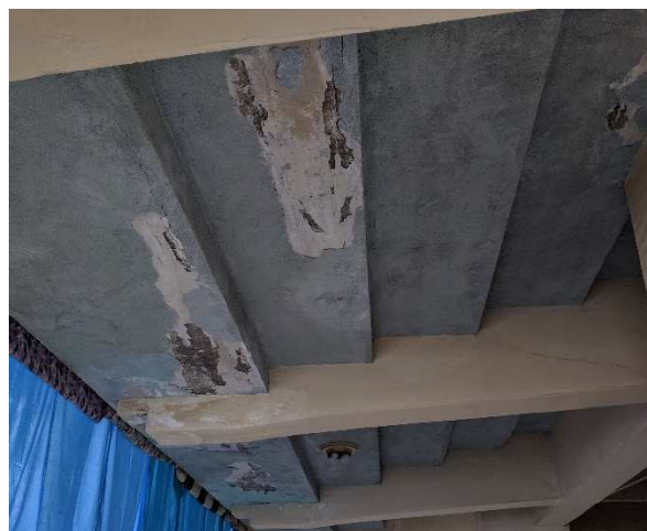
Photo 7b – Structure du jubé endommagée – Août 2019
