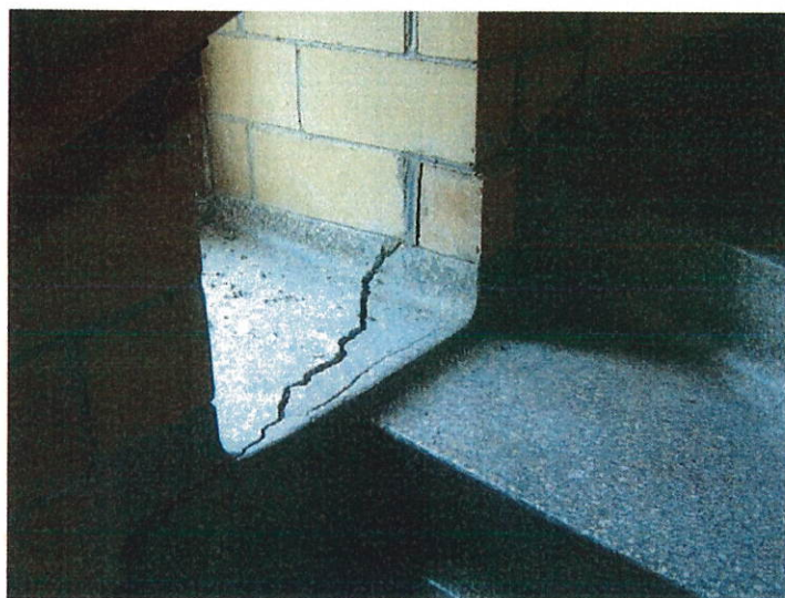
Photo 3 : Clocher - Fissure dans le mur du clocher
