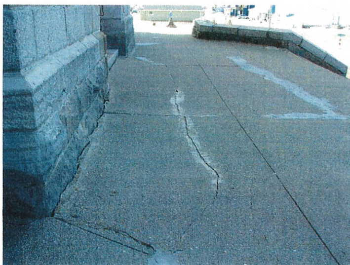
Photo 27 : Parvis de l'entrée - Fissure dans la dalle
