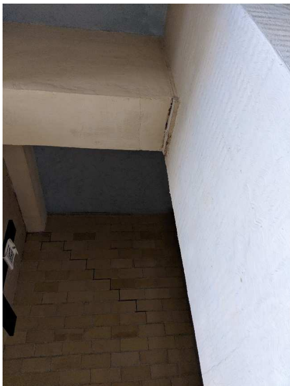
Photo 11 – Structure du jubé – Fissure en cisaillement sur la poutre – Août 2019
