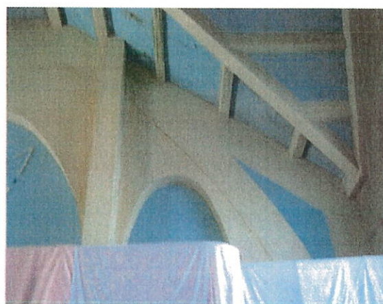
Photo 11b : Arche de l'entrée – Fissure de l'arche – Janvier 2013
