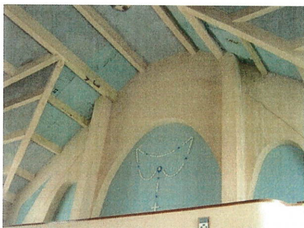
Photo 6a : Église - Dalle et poutres de la toiture endommagées ; Béton pourri et armature corrodée – Juin 2009
