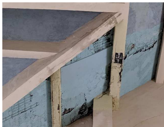
Photo 6b - Nef de l'église - Dalle et poutres de la toiture endommagées; Béton pourri et armature corrodée - Août 2019
