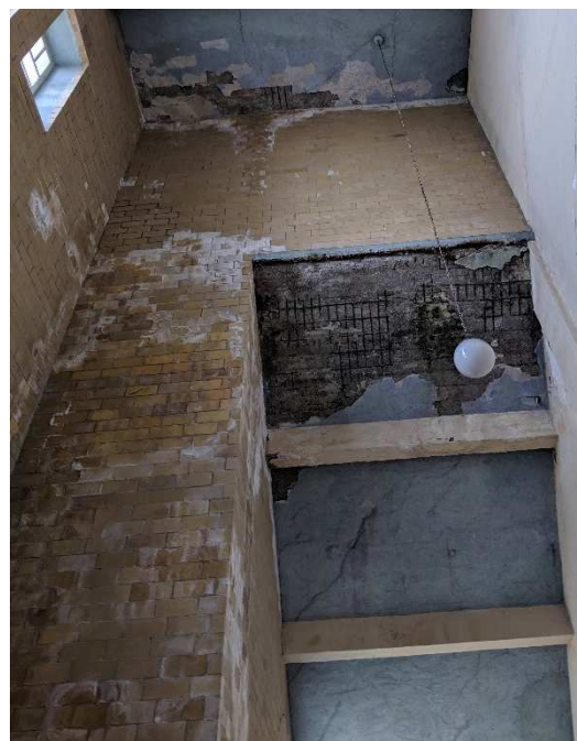
Photo 3b - Clocher – Béton endommagé et pourri, armature corrodé; infiltration d'eau avec traces de calcaire – Août 2019
