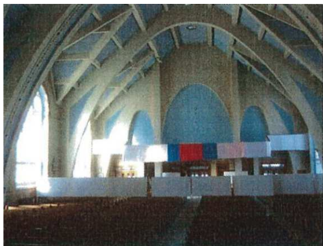
Photo 9a – Arche de l'entrée – Fissure sur la périphérie – Janvier 2013
