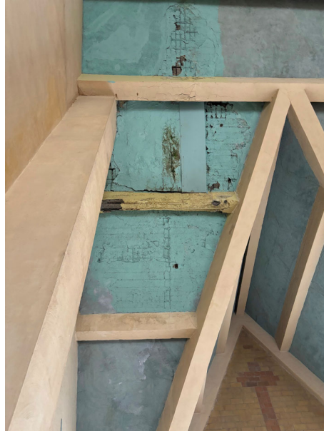
Figure 11 : Dommages sur la structure de la toiture
