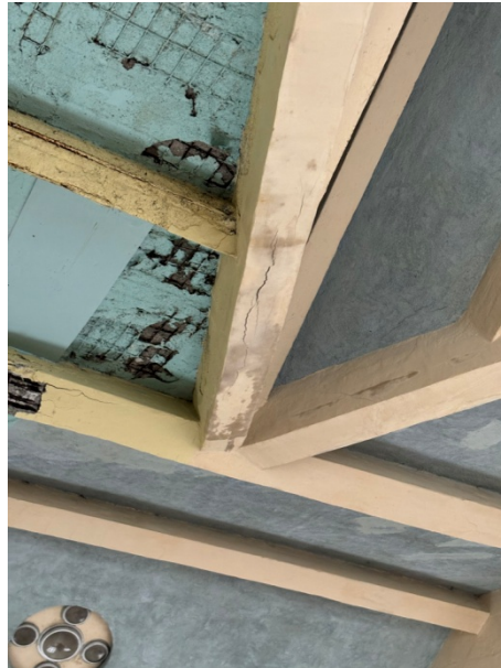
Figure 10 : Dommages sur la structure de la toiture
