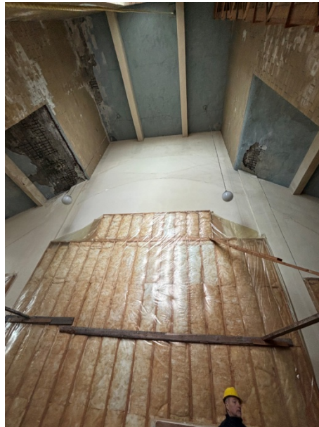
Figure 13 : Dommages dans le narthex
