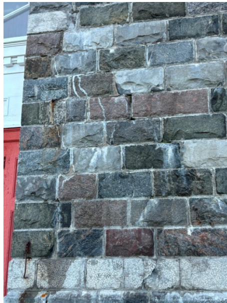
Figure 20 : Joints craqués et éléments fendus dans la maçonnerie extérieure
