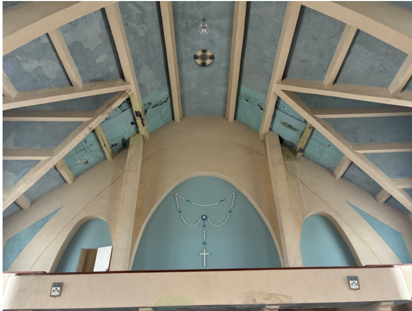
Figure 8 : Dommage entre la première arche et le clocher
