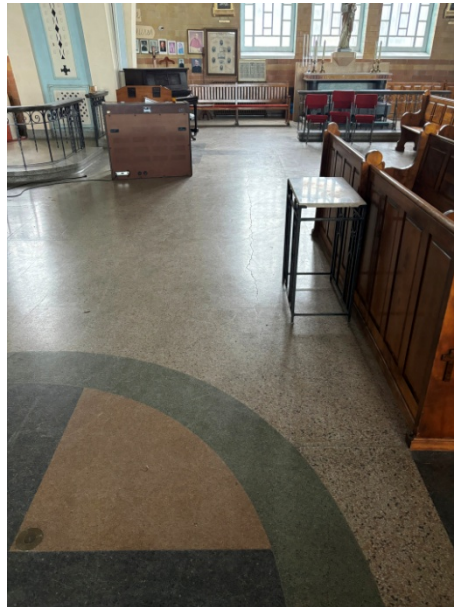
Figure 5 : Fissure dans le plancher de la nef
