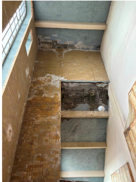
Figure 12 : Dommages dans le narthex
