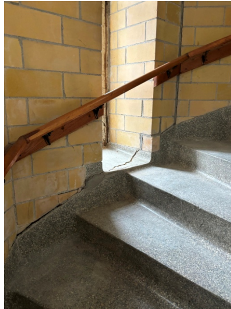
Figure 16 : Dommages dans la tour ouest
