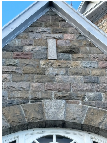
Figure 23 : Joints craqués de la maçonnerie extérieure
