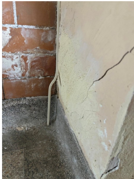
Figure 18 : Efflorescence sur la maçonnerie
