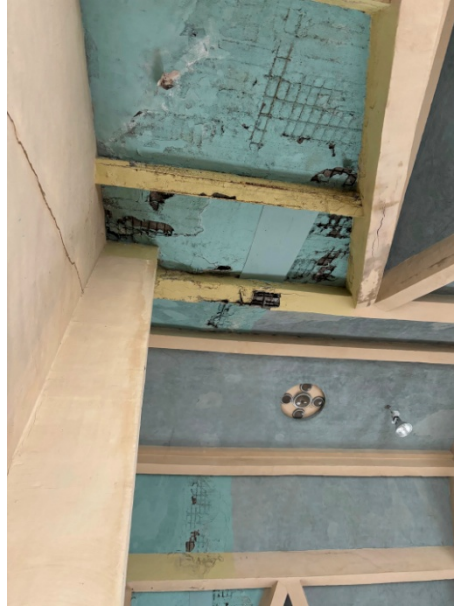
Figure 9 : Dommages sur la structure de la toiture
