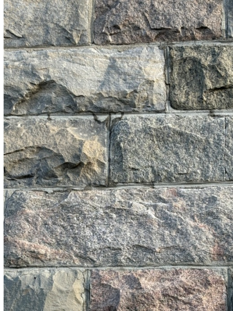
Figure 19 : Joints craqués et éléments fendus dans la maçonnerie extérieure
