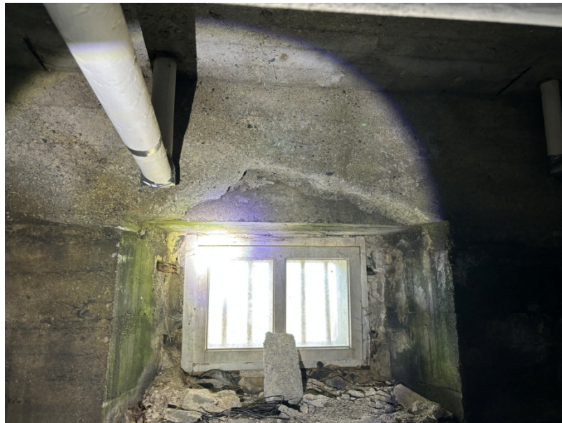
Figure 4 : Tête de fenêtre abîmée
