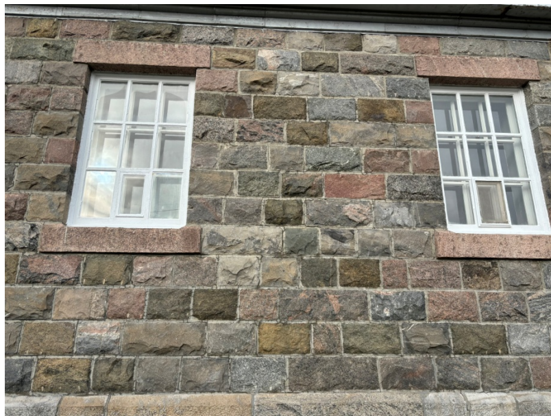
Figure 24 : Joints craqués de la maçonnerie extérieure au sud de la sacristie
