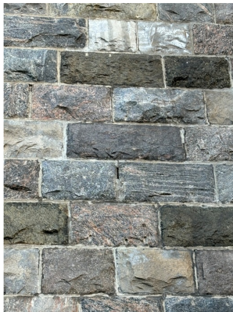
Figure 22 : Joint vide de la maçonnerie extérieure
