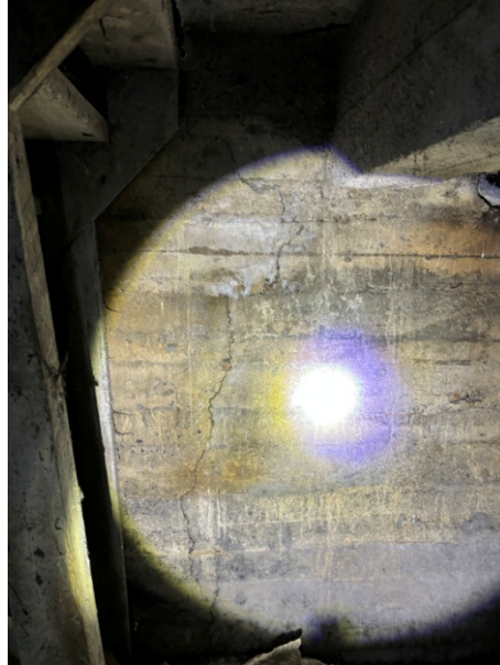
Figure 3 : Fissure de retrait dans les murs de fondation
