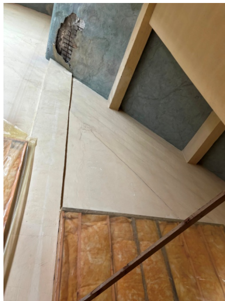
Figure 14 : Dommages dans le narthex
