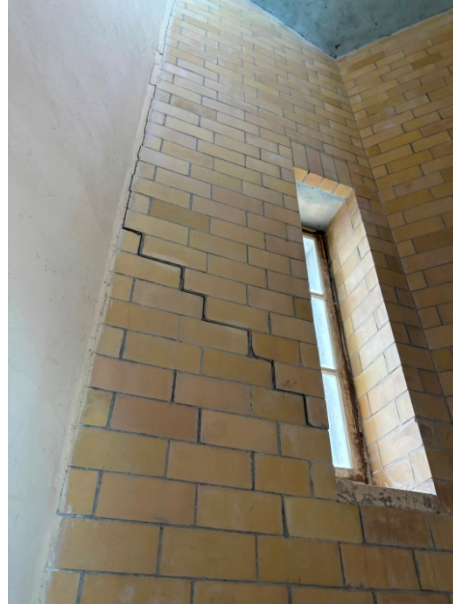
Figure 15 : Dommages dans la tour ouest
