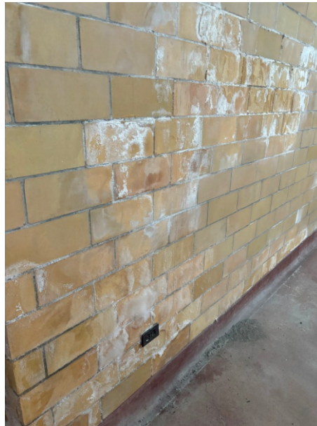
Figure 17 : Efflorescence sur la maçonnerie
